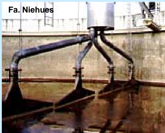
Saugräumung im Rundbecken suck scraper in round tanks
