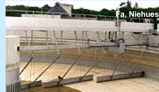
Schildräumer im Rundbecken shield scraper in round tanks
