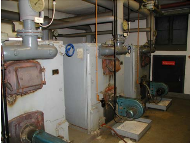
Abb. 5 Durch hohe Oberflächentemperaturen (Gebläse 146 °C, Ofenklappe 127 °C, Sammelrohr 79°C, Kesselmantel: 39 - 45°C) der Kessel sind auch die Abstrahlverluste hoch.
