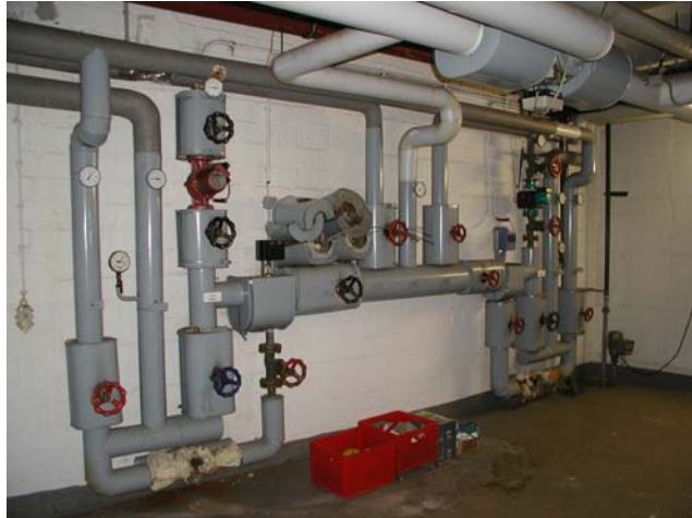
Abb. 6 Die Verteilstationen im Nahwärmenetz (hier im Bauteil I) sind gleichermaßen in schlechtem Zustand, so dass eine Regelung - selbst von Hand - kaum möglich ist. Auf dem Bild hier sieht man den Heizkreisverteiler mit den Abgängen für die rechte und linke Gebäudehälfte und für das Nahwärmesystem.
