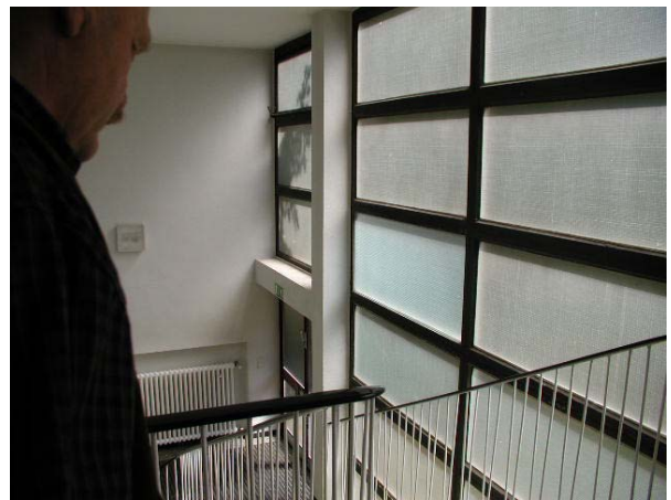
Abb. 32 Einfachverglasung im Treppenhaus
