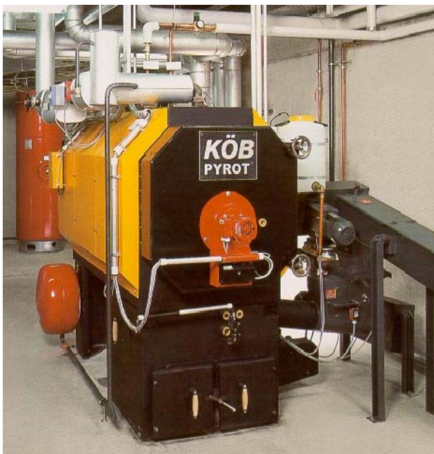
Abb. 35 Kessel für Holzpellets
