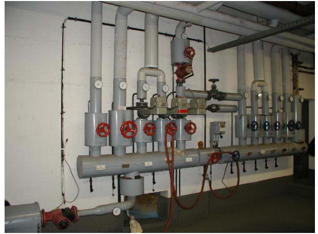
Abb. 8 Veraltete Verteilstationen im Nahwärme-netz (hier im Bauteil III)
