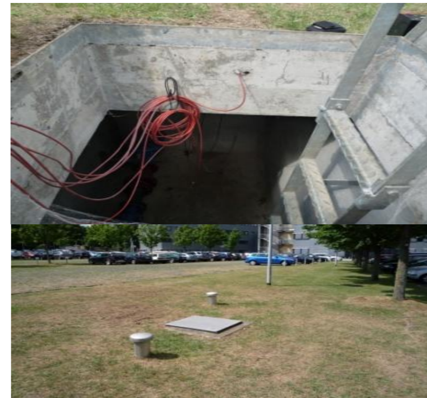
Abb. 4: Bodentemperaturmessung im Trinkwasserschacht
