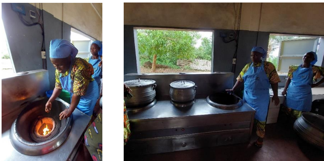
Fig. 20, 21 : Foyer Atingan, où le souffleur est actionné par énergie solaire.
