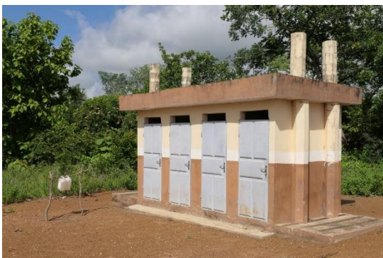
Fig. 10 : Une nouvelle latrine, et même un tippy-tap ont été installés pour la visite de l'équipe, mais on a oublié de déverrouiller les portes.
