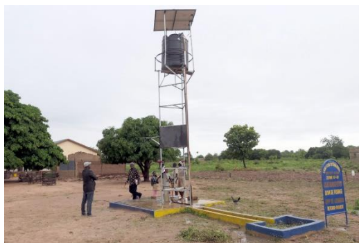
Fig. 30 : Un forage, équipé à l'origine d'une pompe manuelle, a été modernisé par une fondation donatrice européenne et fonctionne désormais avec des panneaux solaires, une pompe électrique et un petit château d'eau. Hélas, il se trouve à plus de 75 m de la cuisine.
