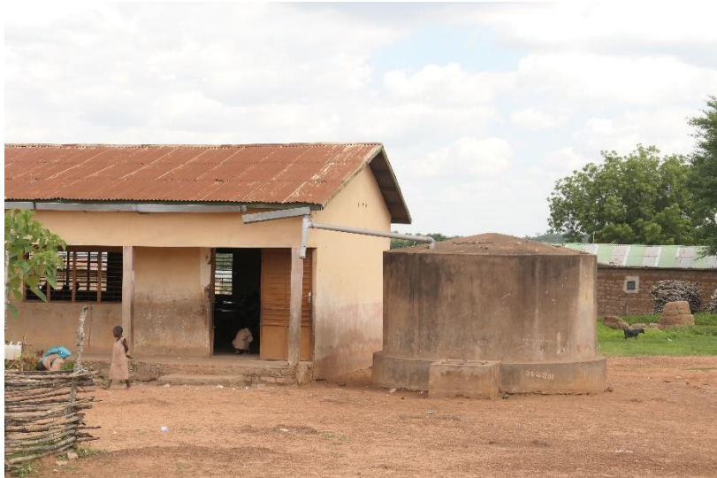
Fig. 31 : Dispositif de collecte des eaux pluviales avec un tuyau de chute défectueux
