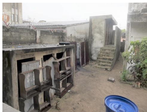
Fig. 11 : Image insolite à Cotonou : l'ancienne latrine est remplie d'ordures (à gauche sur la photo), celle à peu près fonctionnelle (en haut à droite) est fermée, et entre les deux se dresse un « pissoir » à peine recouvert d'une tôle ondulée, et où du charbon de bois a été dispersé sur le sol
