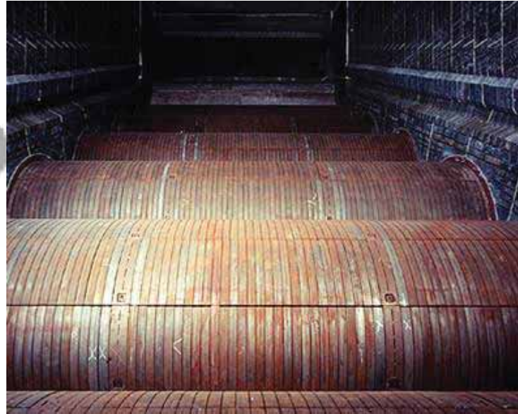
Vom Abfall zum Wirtschaftsgut? – Walzenrost in einer Hausmüllverbrennungsanlage
