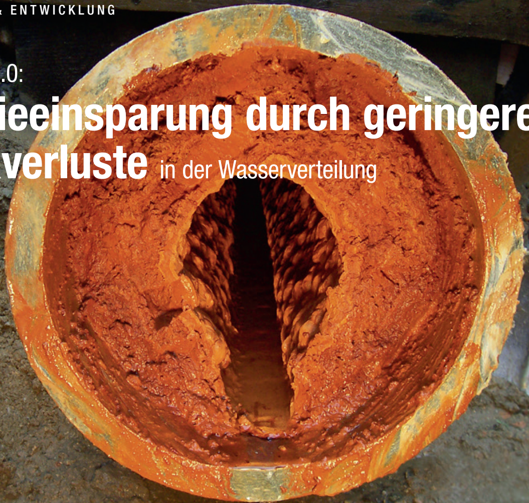
Querschnittsreduzierung einer Rohwasserleitung, bedingt durch Ablagerungen
