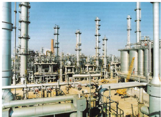
Foto: Ethylen-Anlage (ROW Wesseling)
