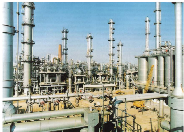
Foto: Ethylen-Anlage (ROW Wesseling)
