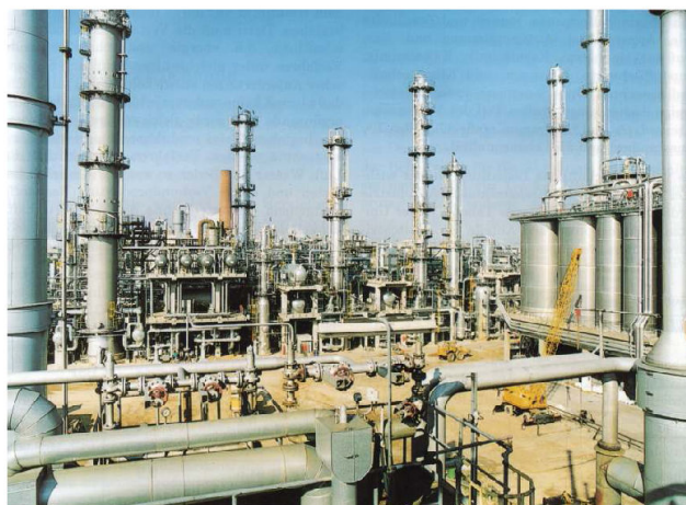
Foto: Ethylen-Anlage (ROW Wesseling)
