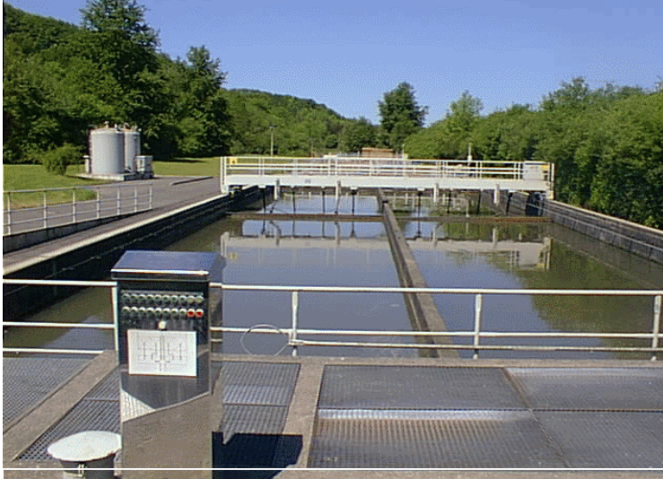
KA Lennestadt-Grevenbrück: Nachklärbecken und FeCl 3 Dosierstation
