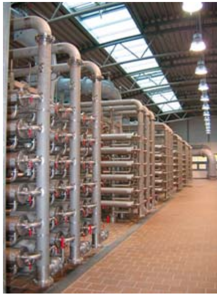
Abbildung 1: UF-Blöcke der Trinkwasseraufbereitung (1. Stufe)
