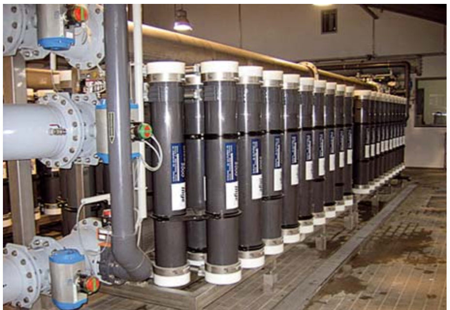
Abbildung 2: UF-Block der Spülwasseraufbereitung (2. Stufe)
