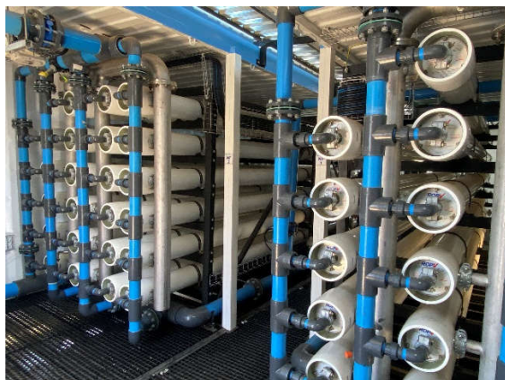
Nanofiltration zur Entsalzung
