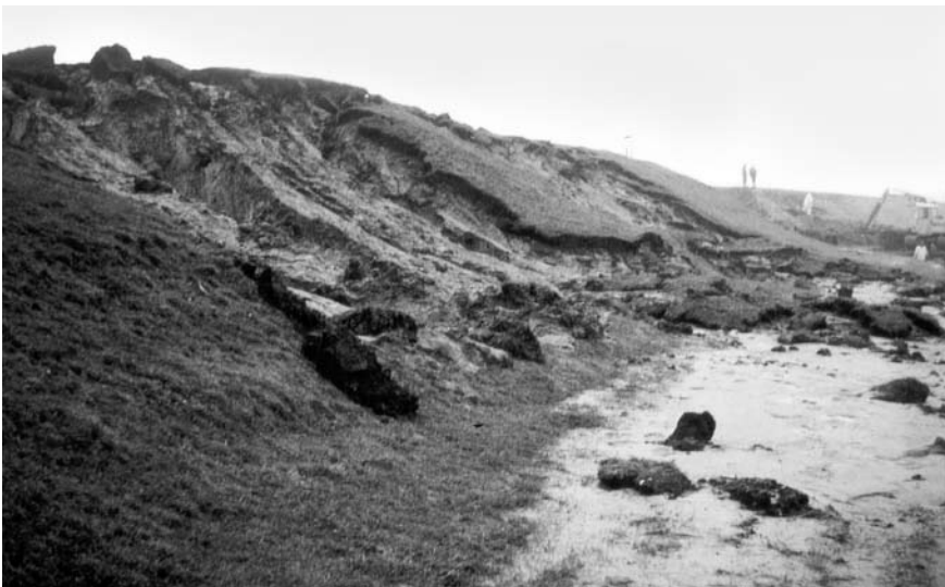
(1) Grobe Schäden an einer Binnenböschung (Christianskoog). Quelle: ALW-Husum
